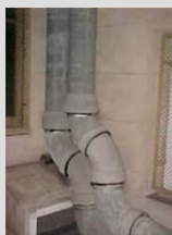
Canonades de fibrociment
